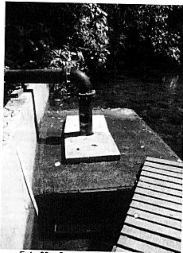
Foto 09 – Captação Rio Guaxinduba
