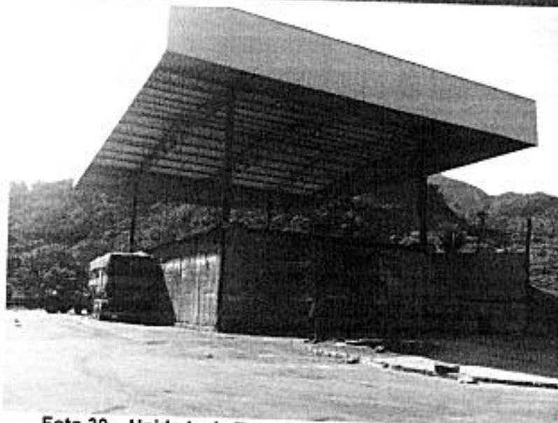
Foto 30 – Unidade de Transbordo Bairro das Gaivotas (Fonte: Prefeitura Municipal da Estância Balneária de Caraguatatuba)
