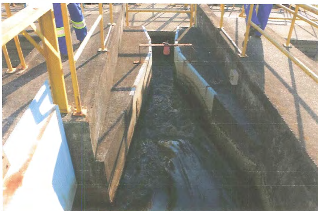
Foto 47: ETE Porto Novo – Medidor Parshall.
