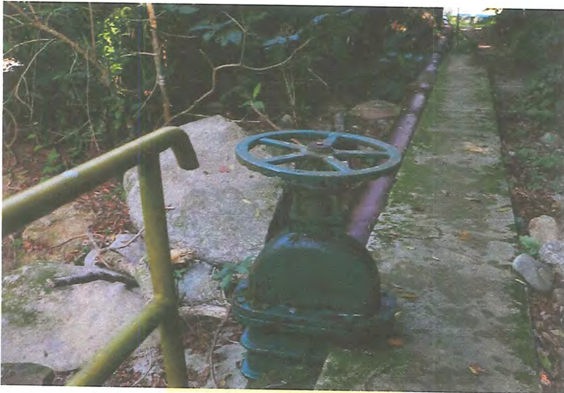
Foto 13: Sistema Guaxinduba – Adutora de Água Bruta (AAB).
