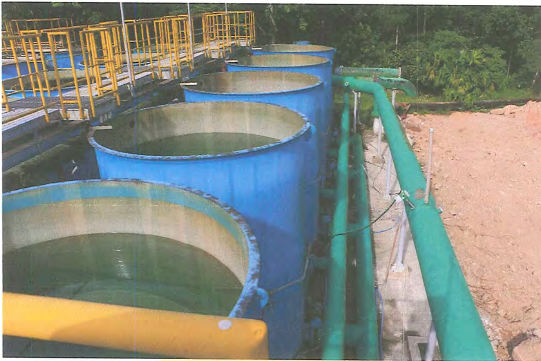
Foto 19: Sistema Guaxinduba – ETA – Filtro Rápido de Dupla Camada Ascendente.
