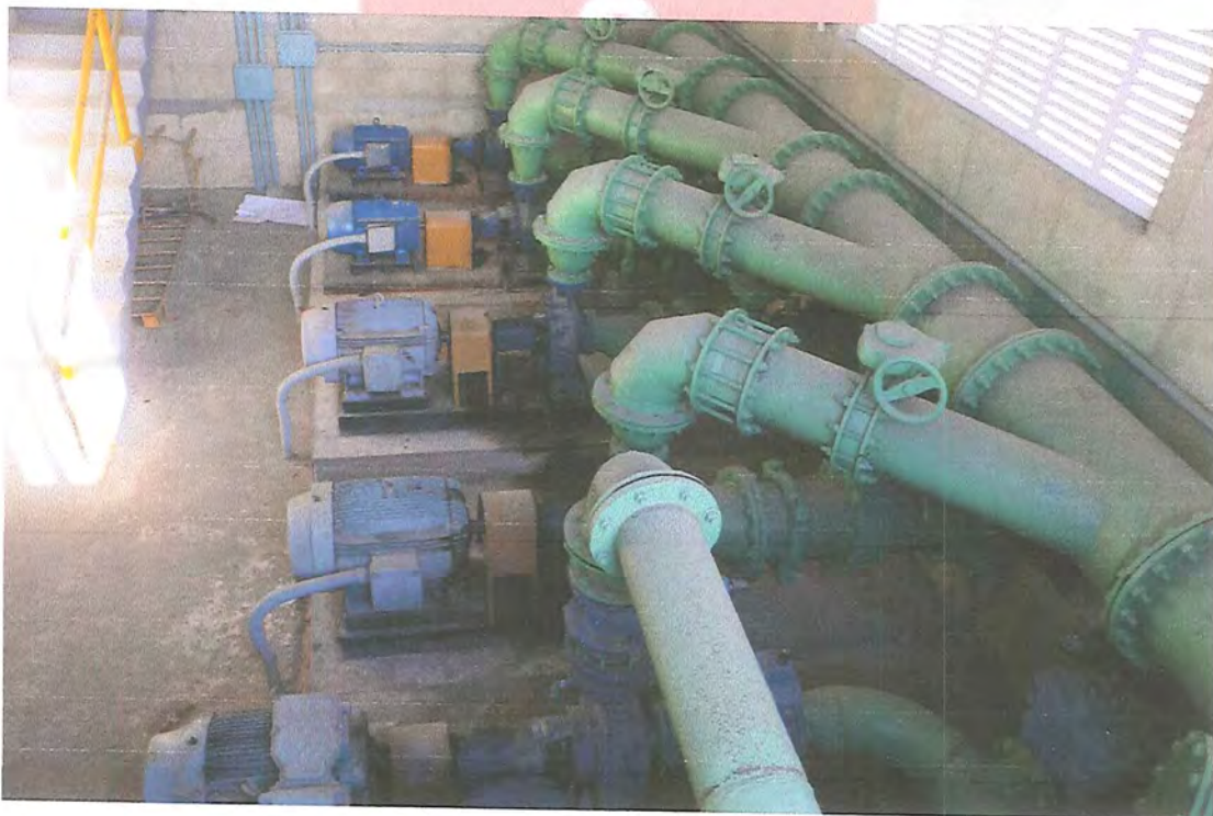
Foto 10: Sistema Porto Novo – EEAT Palmeiras Norte.
