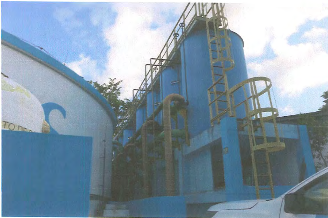
Foto 25: Sistema Massaguaçu – ETA Massaguaçu – Sistema de Filtros.
