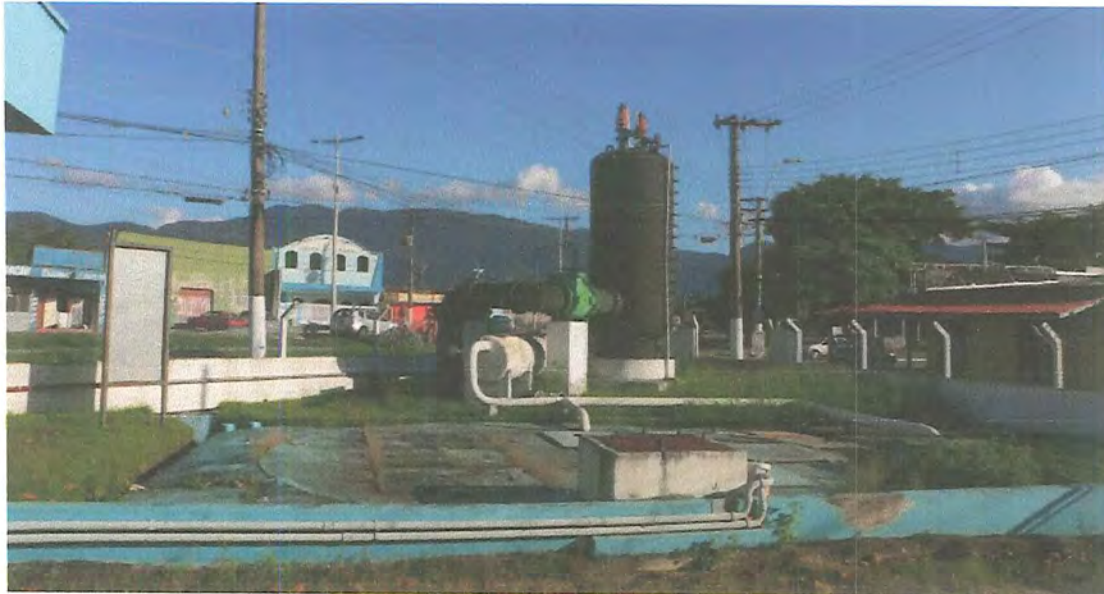
Foto 45: Sistema Esgotamento Sanitário (SES) Porto Novo – Estação Elevatória de Esgotos (EEE) Final Porto Novo.
