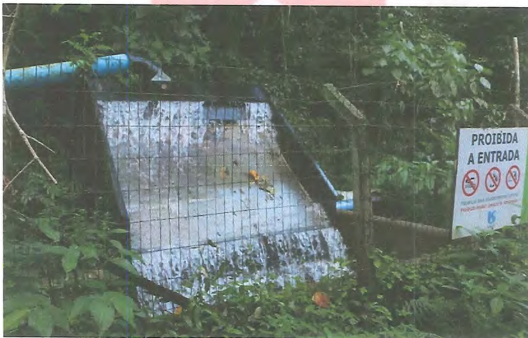
Foto 24: Sistema Massaguaçu – Captação Rio Mococa – Peneira Estática.
