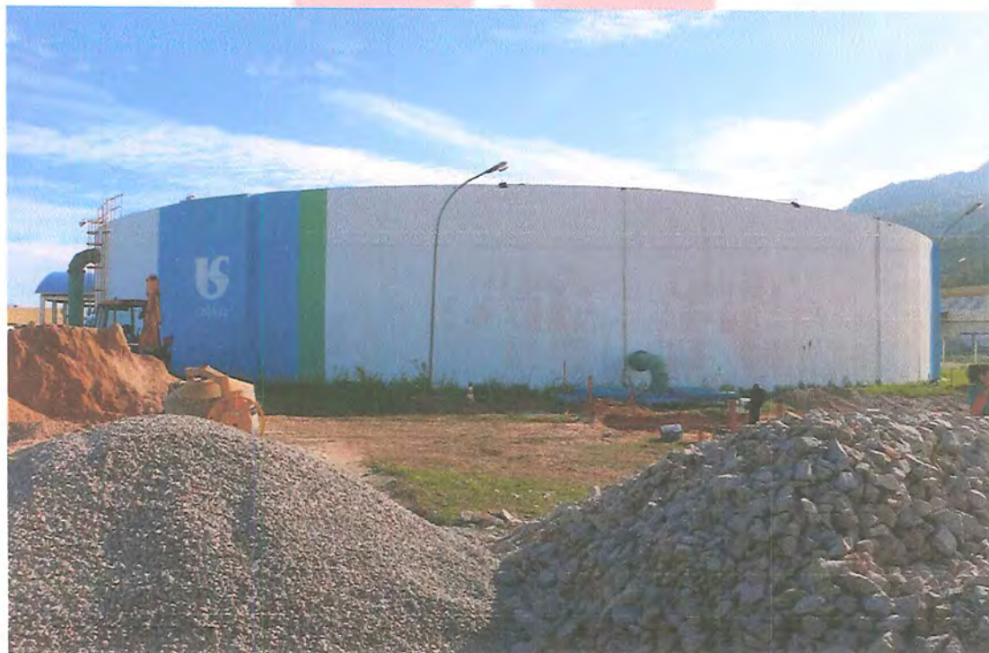
Foto 12: Sistema Porto Novo, Reservatório Palmeiras Norte.
