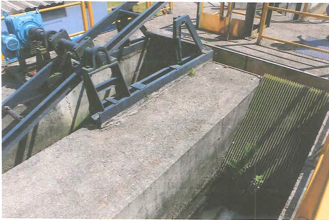
Foto 57: Sistema Esgotamento Sanitário (SES) Martin de Sá – Estação de Tratamento de Esgotos (ETE) Martin de Sá – Gradeamento.
