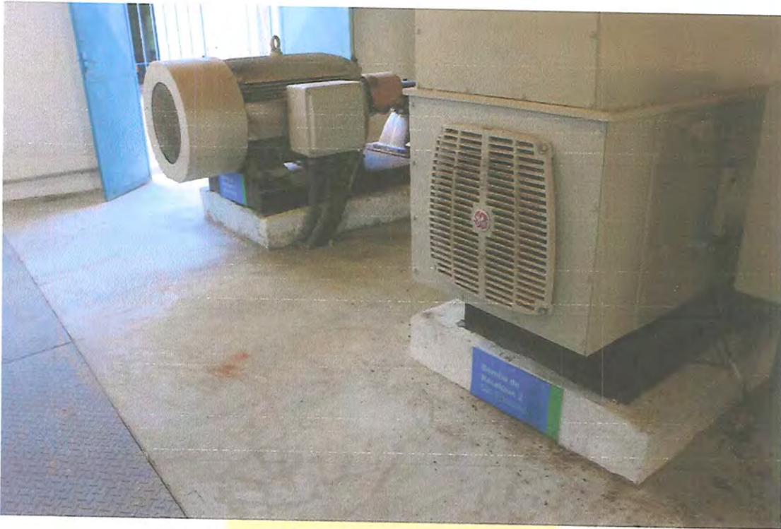
Foto 9: Sistema Porto Novo - EEPE5 (para São Sebastião).
