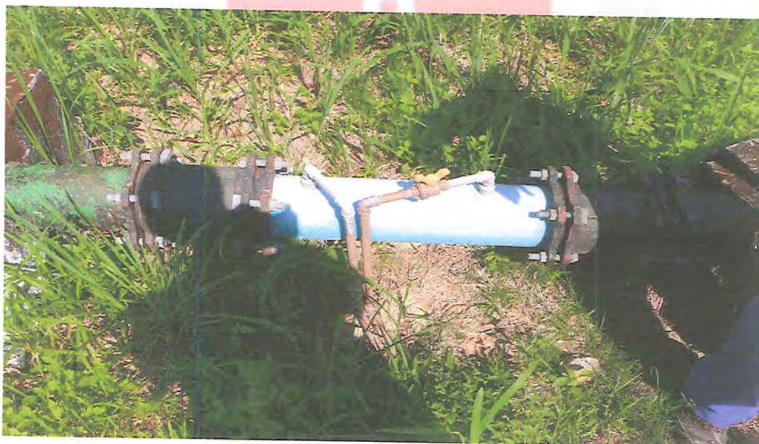
Foto 34: Sistema Tabatinga – ETA Tabatinga – Aplicação de Cloro e Flúor.
