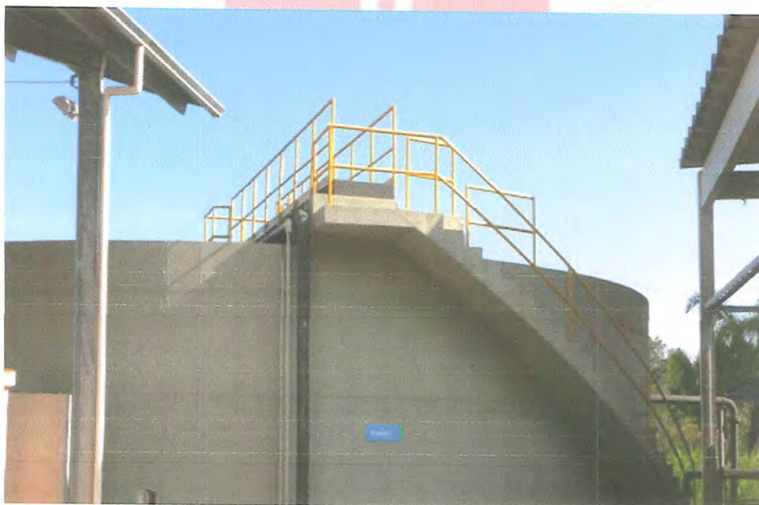
Foto 54: Sistema Esgotamento Sanitário (SES) Indaiá – Estação de Tratamento de Esgotos (ETE) Indaiá – Adensador de Lodo.
