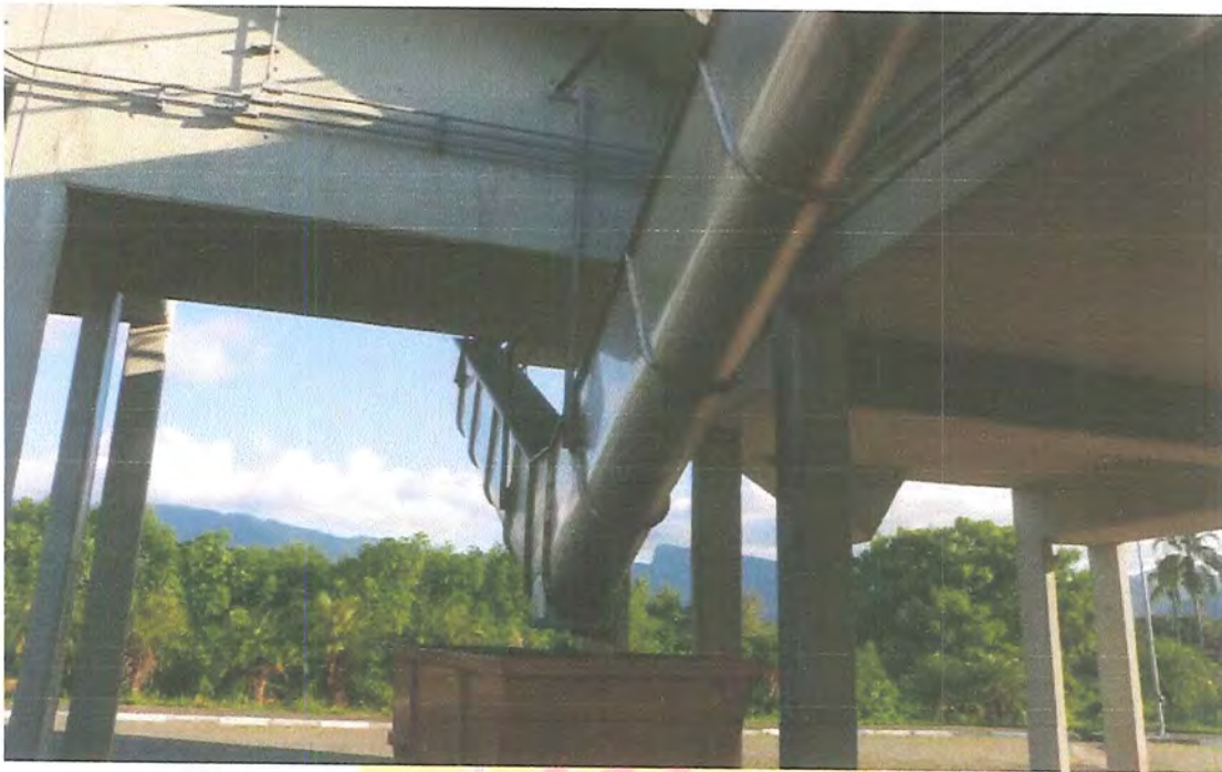
Foto 51: ETE Porto Novo – Acondicionamento de Lodo (sólido) em Caçambas.
