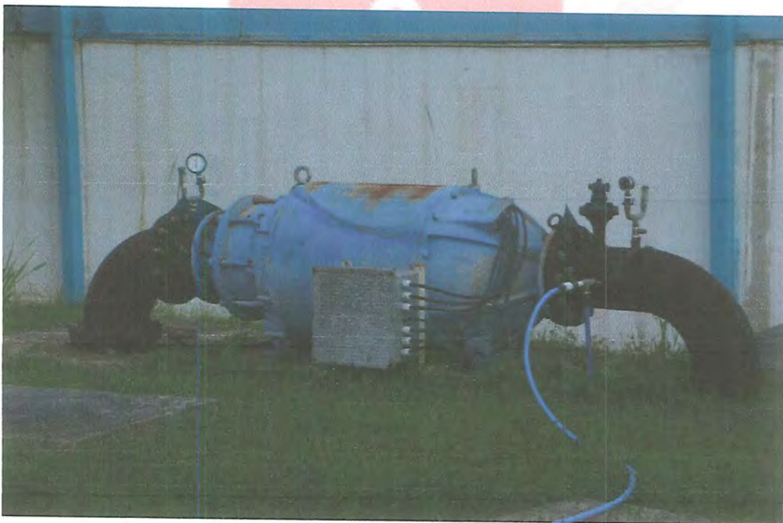
Foto 30: Sistema Tabatinga – Estação Elevatória de Água Bruta (EEAT).
