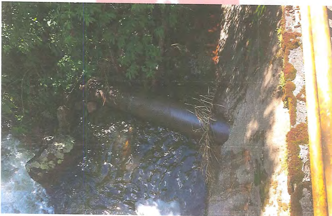
Foto 4: Sistema Porto Novo – Adutora de Água Bruta AAB.
