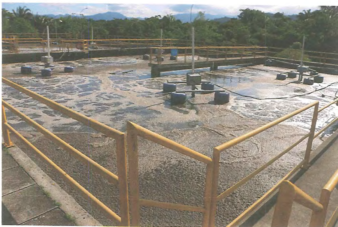
Foto 53: Sistema Esgotamento Sanitário (SES) Indaiá – Estação de Tratamento de Esgotos (ETE) Indaiá – Aeradores Mecanizados Superficiais.
