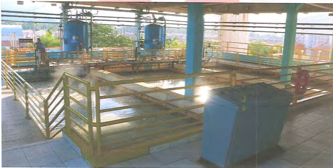
Foto 6: Sistema Porto Novo – ETA Porto Novo – Sistema de Flotação.
