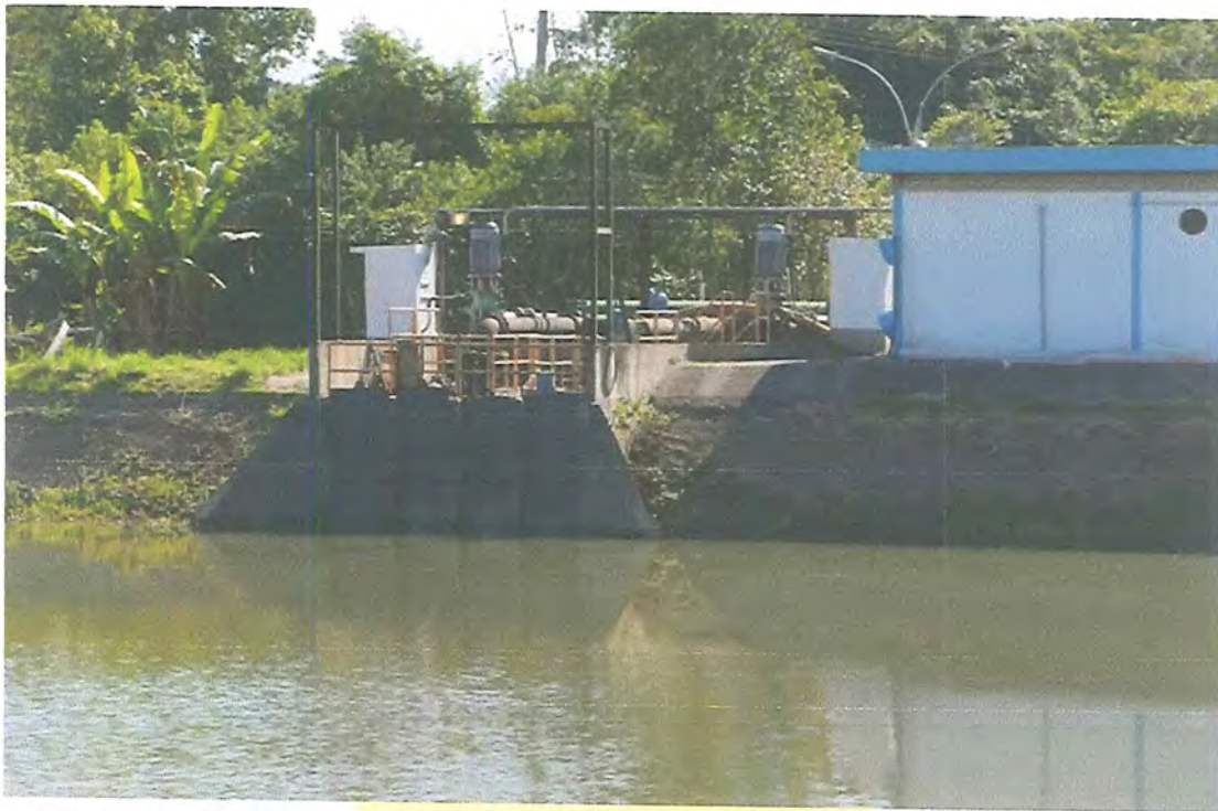
Foto 3: Sistema Porto Novo - Estação Elevatória de Água Bruta EEAB Baixo Rio Claro.
