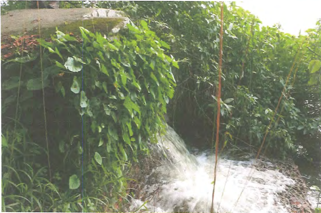
Foto 41: Ponto de lançamento do efluente tratado na ETE Porto Novo (45377 E 7380186 S)
